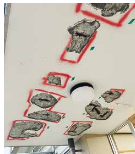
軒天の爆裂（補修前）
