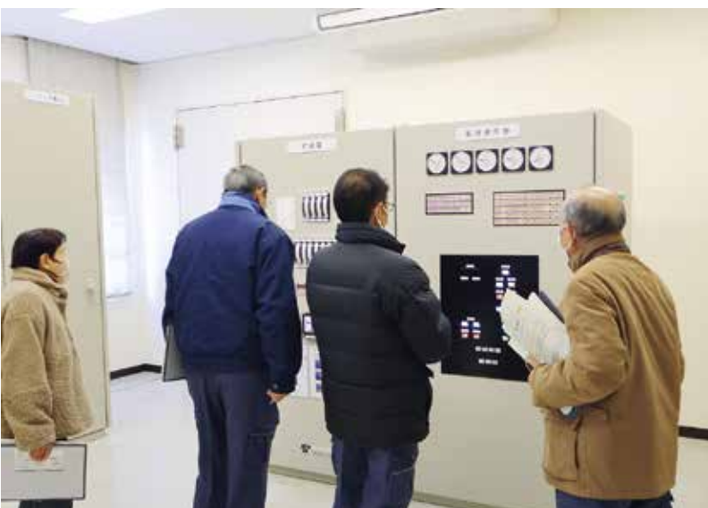
一新された制御盤
